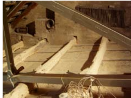
10.11.2004: Sanierung der Holzbalken der Innendecke (Nordost-Ecke): die vom Hausbock befallenen Partien der Holzbalken sind entfernt («bebeilt»), teilweise musste über 50 % des Balkenquerschnitts entfernt werden
