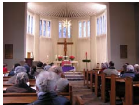
12.12.2004: Die neue Apsisbeleuchtung verdeutlicht die Dringlichkeit weiterer Sanierungsarbeiten im 2. Bauabschnitt (u. a. Sanierung der Fenster, Freilegung der Sandsteinflächen, Malerarbeiten).
