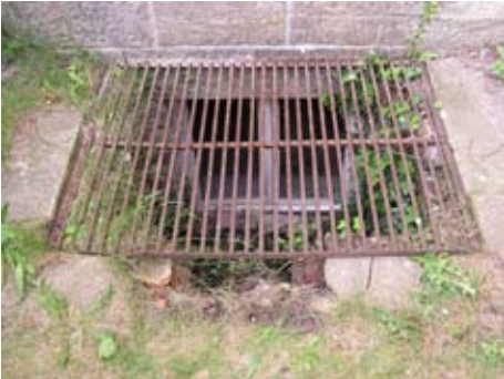
23.05.2006 Stark baufälliger Kellerschacht
