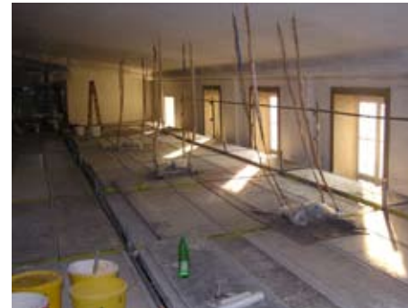
04.07.2005 Nach Feierabend auf der oberen Arbeitsebene des Innengerüsts; im Vordergrund Gewebband und Spachtelmasse für die Sanierung der Risse
