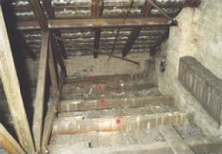
03/2003 Innendecke über Kirchenschiff, Nordostecke: besonders starker Hausbockbefall an abgehängten Deckenbalken
