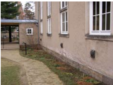
17.01.2004 Schadhafter Putz, alte Abgasauslässe der Gasheizkörper
