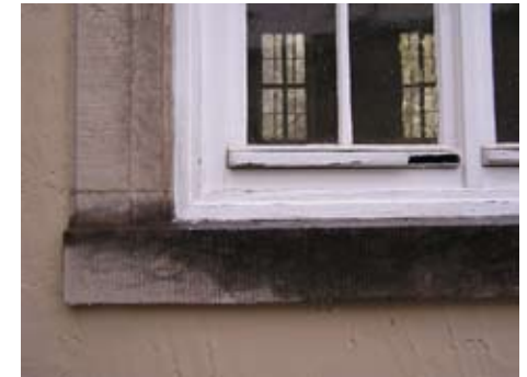
19.11.2004 Fensterdetail auf der Nordseite. Hier hilft auch kein Überstreichen mehr. Die Rahmen müssen originalgetreu saniert werden. Das schöne Antikglas wird erhalten.
