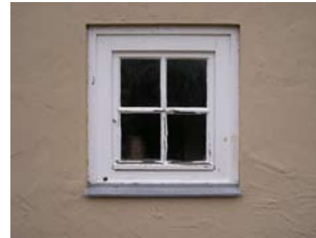
04.02.2005 WC-Fenster mit deutlichen Schäden
