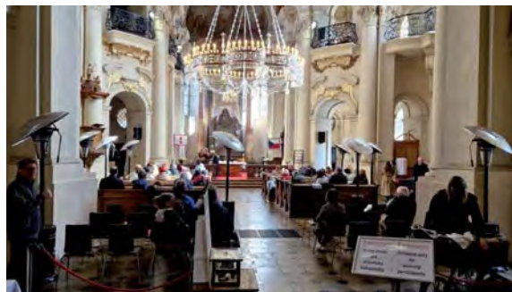
Heizung mit Heizpilzen: St. Nikolaus-Kirche in Prag
