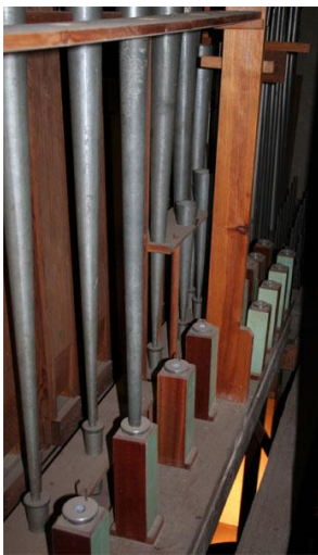
Vorgeschichte: Fehlende Becher der Pedalzunge Posaune 16'
